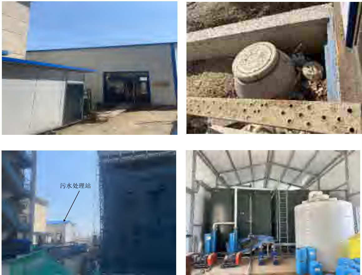
图 4-1 污水处理站及排放口
