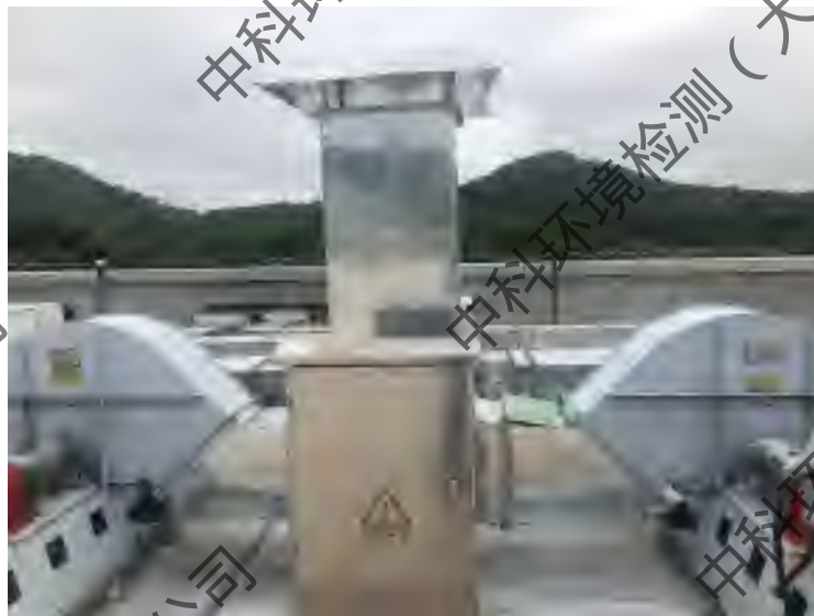
图 3-5 焊接清洗机排气口
